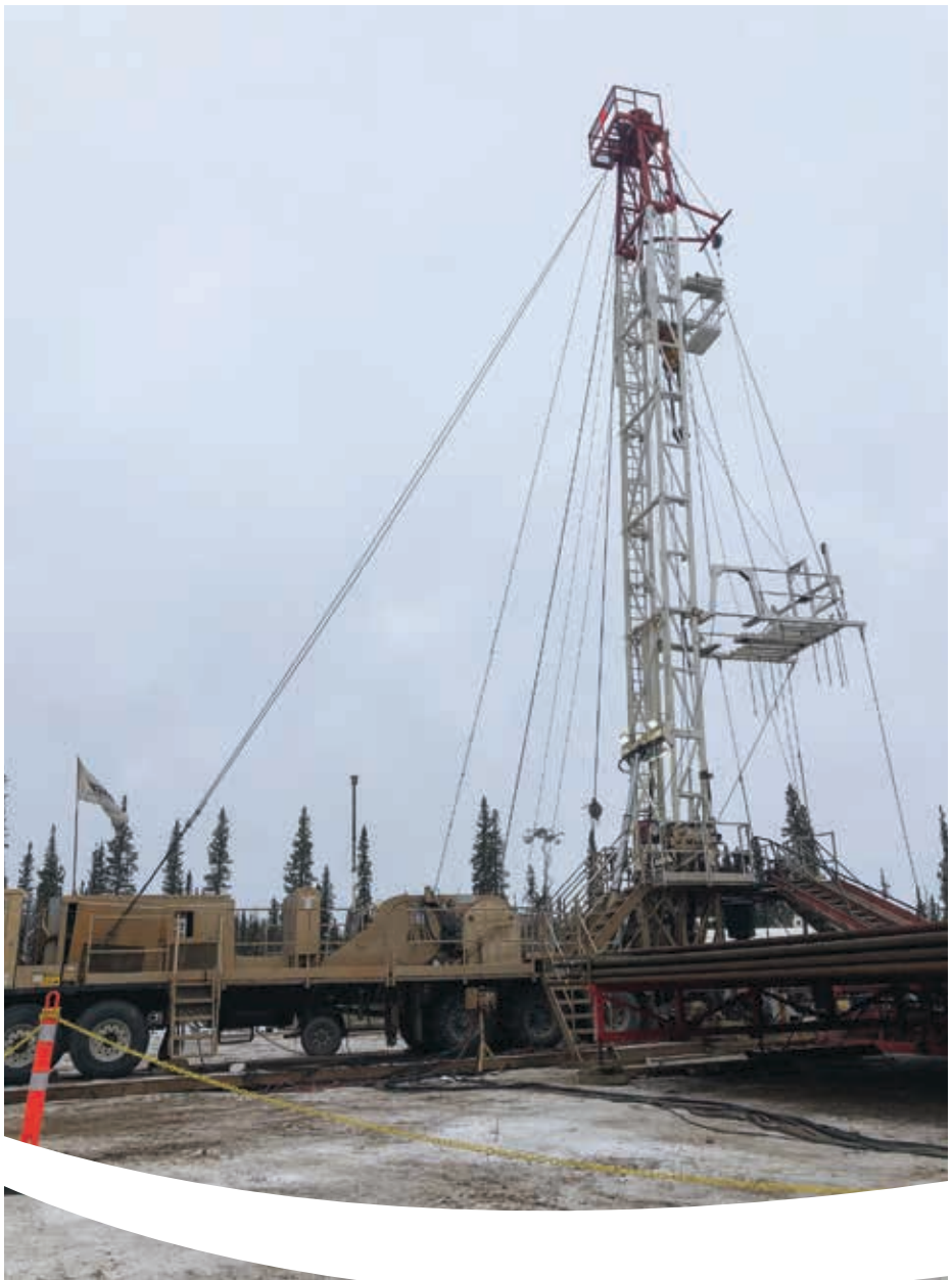
Plateforme de maintenance, région de Fort Liard, février 2020. (Photo : BOROPG)
