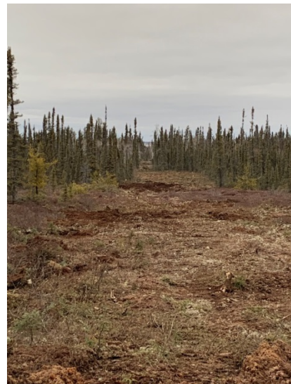
Construction sur la section Edzo du sentier d'accès de 1,3 km de Behchokò.
